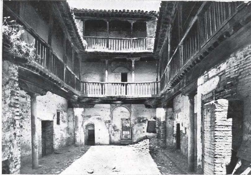
PATIO INTERIOR ANTES DE SU REPARACIÓN.
