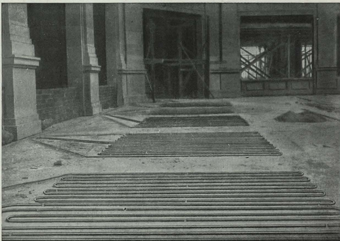
Instalación de calefacción por paneles en el Hall central de público del nuevo edificio del Banco de España en Madrid.
