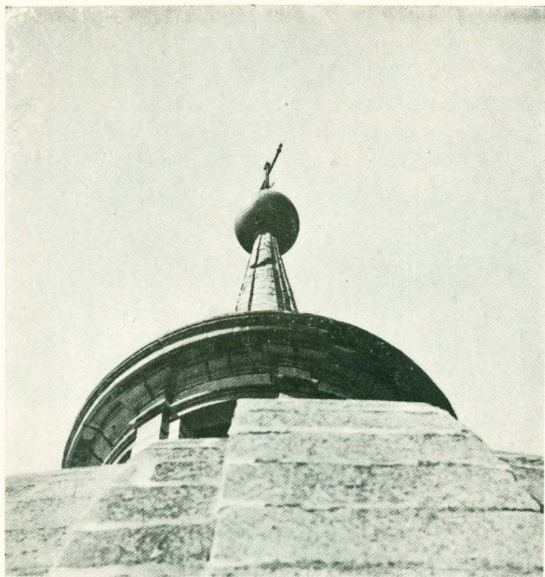
Arriba: Pormenor de la aguja partida. Abajo, a la derecha: La última piedra de la aguja desmontada, comparación de tamaño. Estado de la cantería en el interior del cimborrio.
