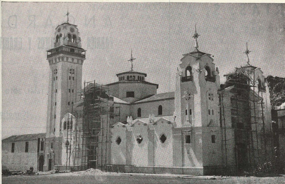
Basilica de Ntra. Sra. de la Candelaria. Proyecto: Arq. Sr. Marrero. En construcción por esta C. a
