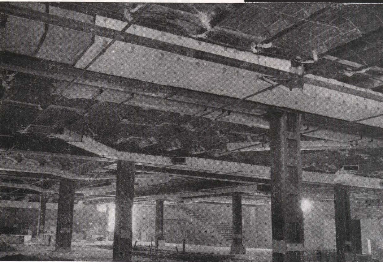
Detalle del aislamiento con paneles POREXPAN de los conductos de aire acondicionado en el "Corte Inglés" de Barcelona.
