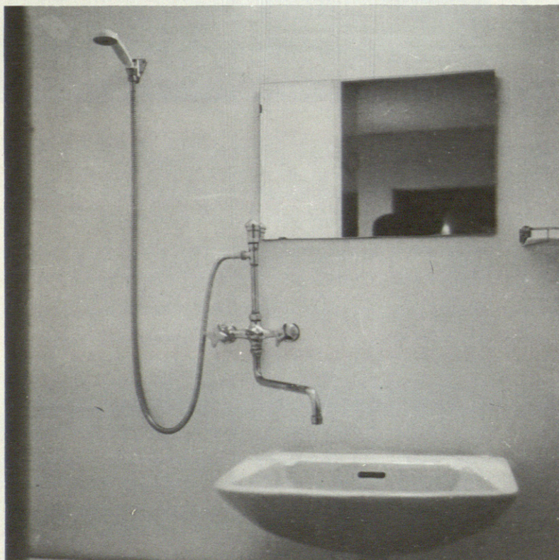
Economía en instalaciones de saneamiento. Dinamarca.
