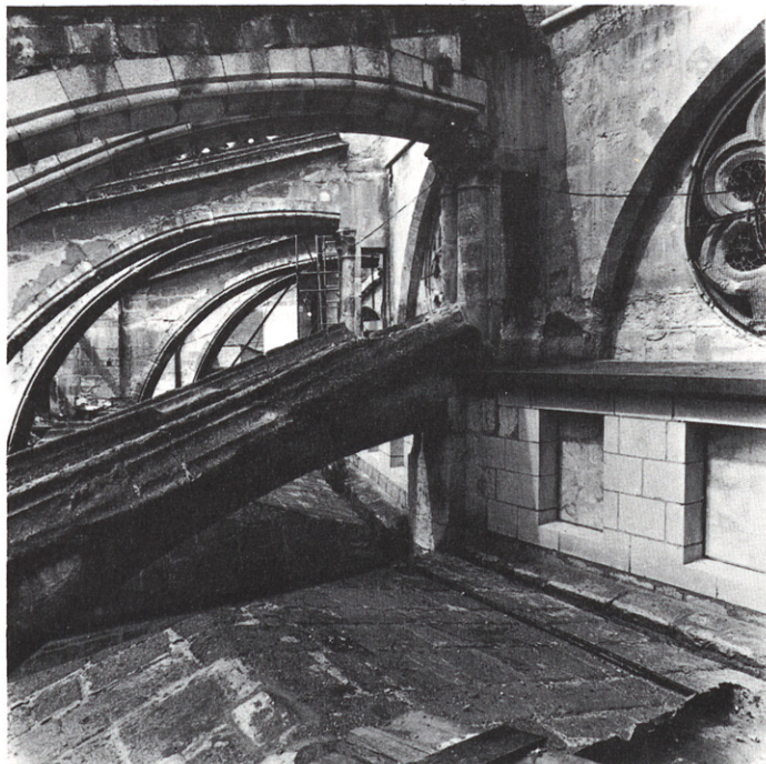
Cubiertas de la girola antes de la restauración. Pirámides de piedra que habían sido realizadas.
