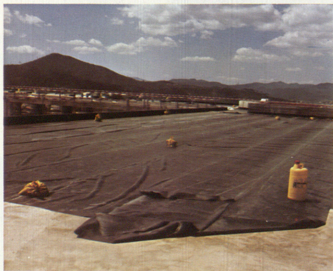
Hospital General de Cataluña. 24.000 m. 2 de láminas de Butilo, en terrazas cubiertas invertidas y jardinería.
