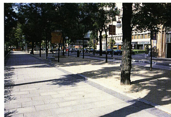
05 - FRAGMENTACIÓN DE UN ANDÉN DE LA SEGUNDA FASE Y FALTAS EN EL PLANTÍO
