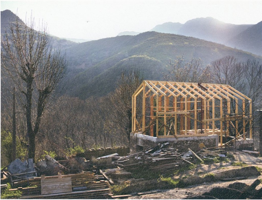
Construcción. Estructura de madera sobre el muro de piedra original. Construction. Timber structure on the original stone wall.
