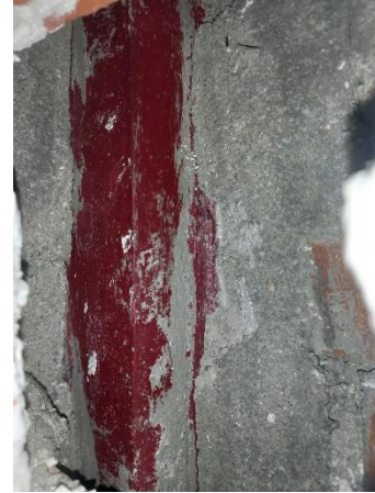
Imagen 4: En puntos como las esquinas, el pilar queda recubierto casi por completo de mortero.
