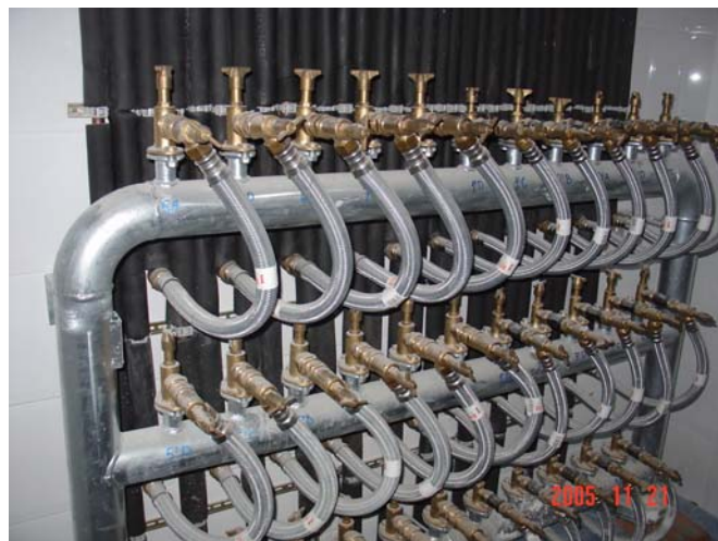
Figura 4: Batería de contadores
