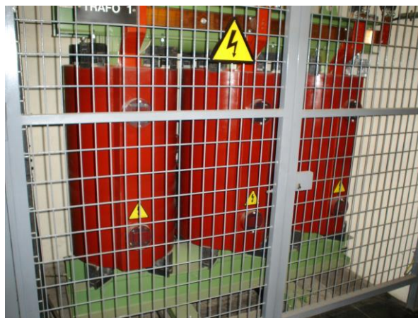
Celda del transformador
