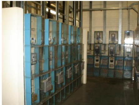
Centralización de contadores
