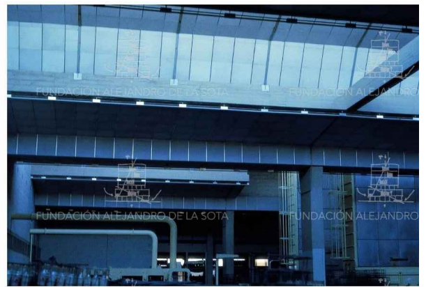
Lucernario + sistema de iluminación artificial
